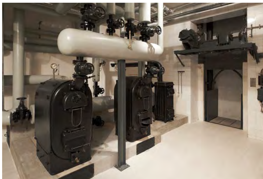
Aby se velký prostor nezobavil topnými tělesy, bylo vytvořeno klimatické zařízení, které bylo možno v létě použít jako vzdušné chlazení. I topení vzduchem fungovalo výtečně, půl hodiny po otevření bylo v celém prostoru teplo.
